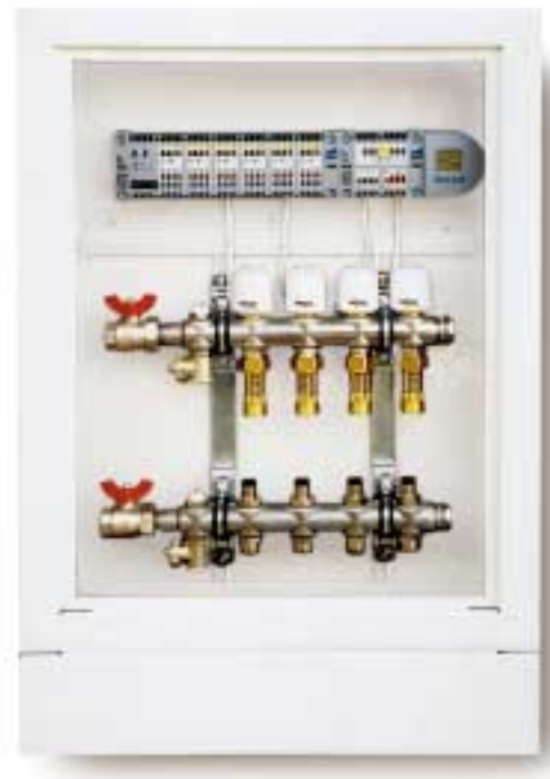
Schaltzentrale mit Raumtemperatur-Steuerung.
